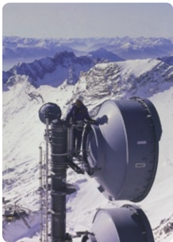
Telekomanlage auf der Zugspitze mit Aluminiumleiter
