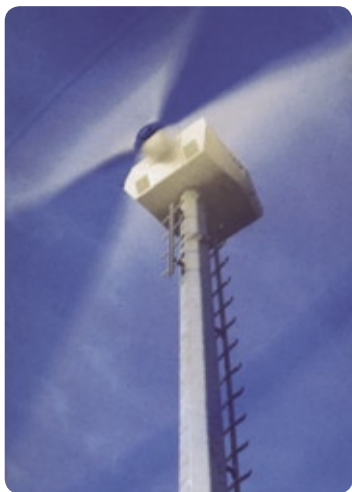
Windkraftanlage mit Steigleiter aus verzinktem Stahl
