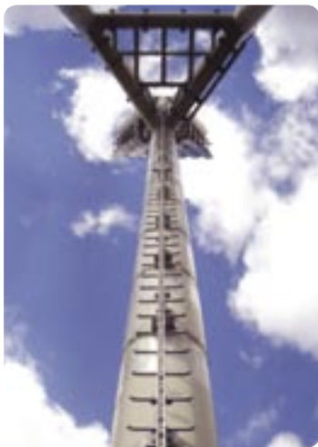
Belysningsmast för belysning på stadion med galvaniserad stegen.
