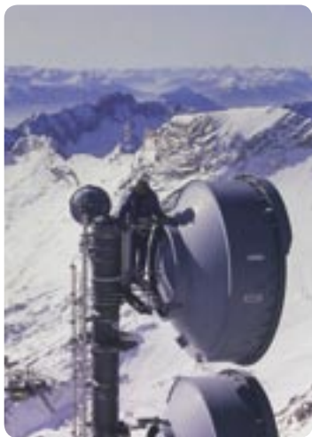
Telekom-anläggning med aluminium stegen på masten.
