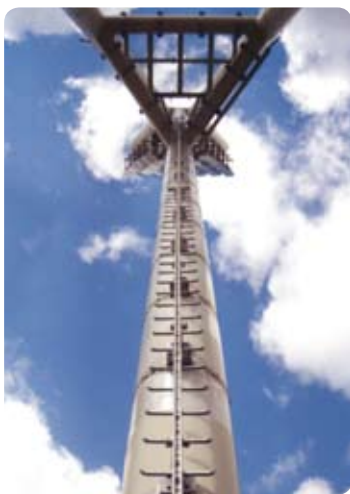
Poste de alumbrado con escalera en acero galvanizado, para la iluminación de un estadio
