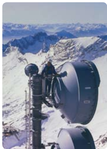
Equipo de telecomunicaciones con escalera de aluminio en el Zugspitze
